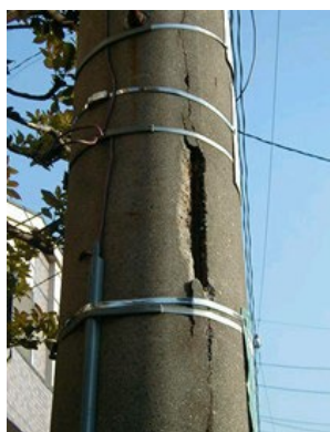
合わせ目の劣化
