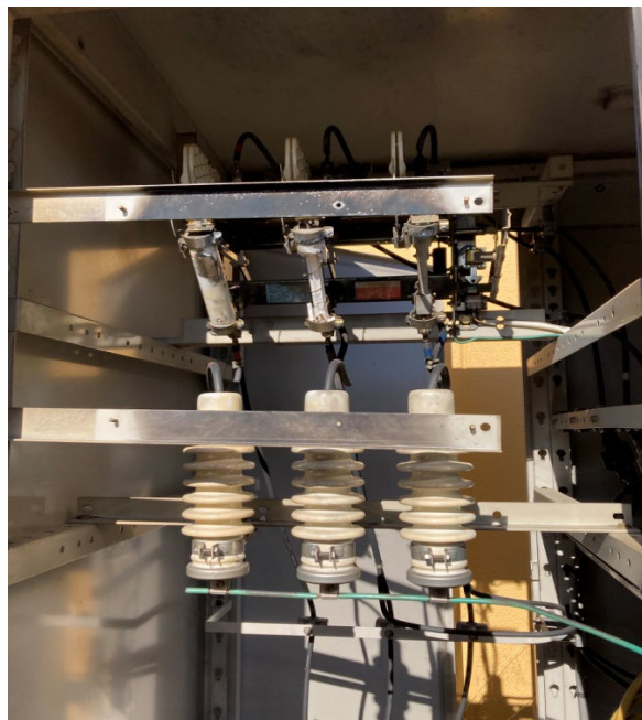
破損した断路器
