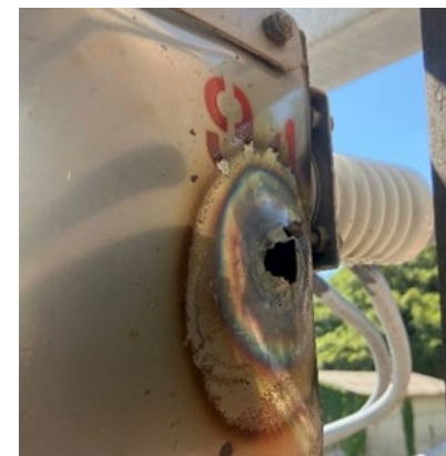
錆による区分開閉器破損(施設後約30年)
