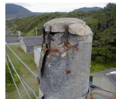
塩害による頂部の剥離
