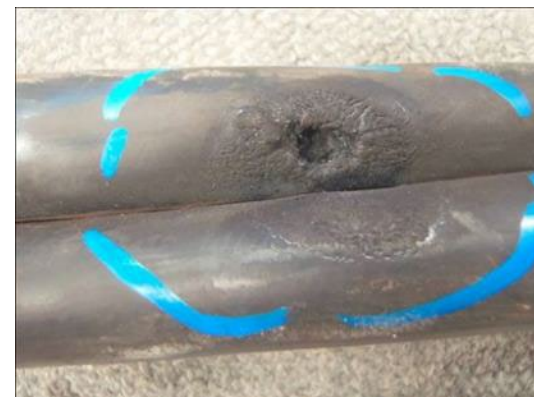
水トリ－による絶縁破壊事例
