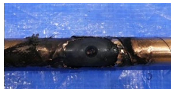
絶縁破壊したケーブルの 遮蔽銅テープ・絶縁体
