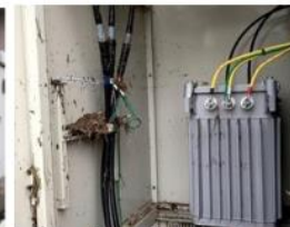
キュービクル内浸水(豪雨・洪水)
