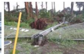
構内柱倒壊(暴風・倒木)
