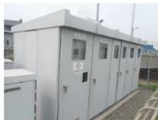
キュービクル（高圧受電設備）
