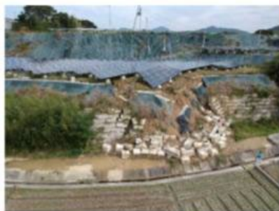
【図1】台風の大雨による事故被害
