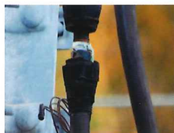
ケーブル内部露出
