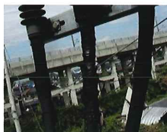
ケーブルヘッド焼損
