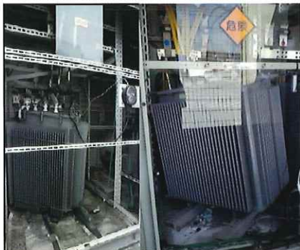
変圧器の移動・転倒
