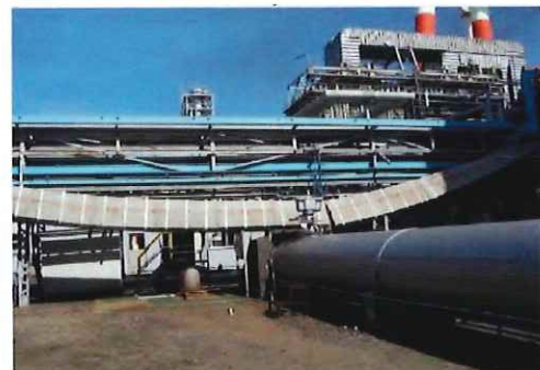
ケーブルダクトが架台から脱落
