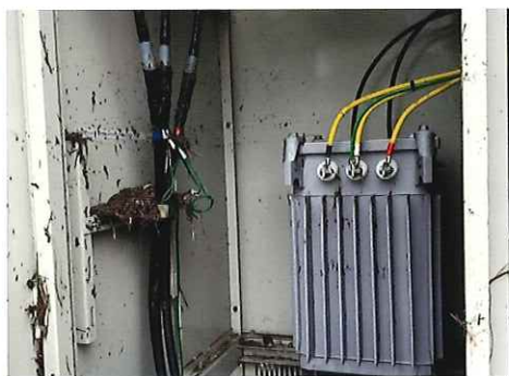
キュービクル内浸水 （豪雨・洪水）
