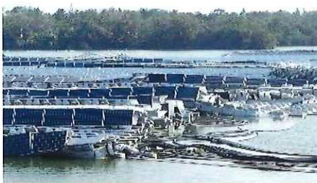
太陽光発電設備崩壊（暴風）
