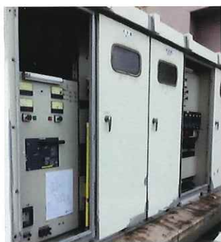
キュービクル扉破損 （暴風）
