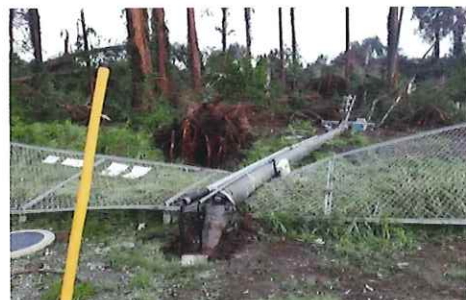
構内柱倒壊（暴風・倒木）
