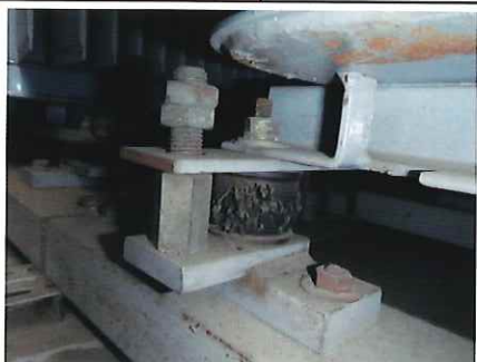
防振ゴム (劣化)
