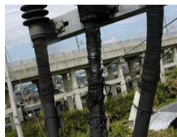
ケーブルヘッド焼損
